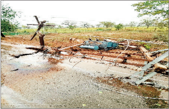
बिरा में अंधड़ से सड़क पर गिरा ट्रांसफार्मर व बिजली का खंभा।
